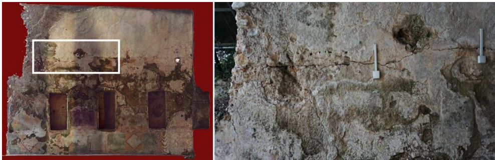
Figura 6 – Una delle principali lesioni in corrispondenza del piano di imposta della volta.
