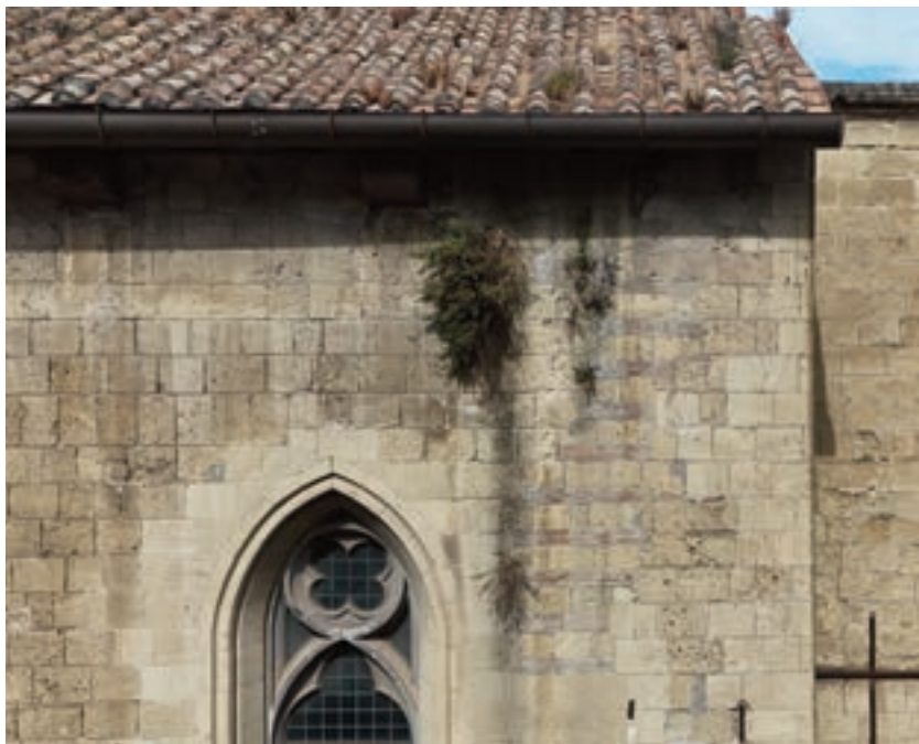
79. Chiesa di s. Maria di Donnaregina. Particolare del prospetto ovest, lato via Duomo. In primo piano un intervento di sostruzione muraria con muratura listata realizzato dopo il terremoto del 1980. Si noti pure la presenza di vegetazione infestante, oltre che segni di efflorescenze saline
