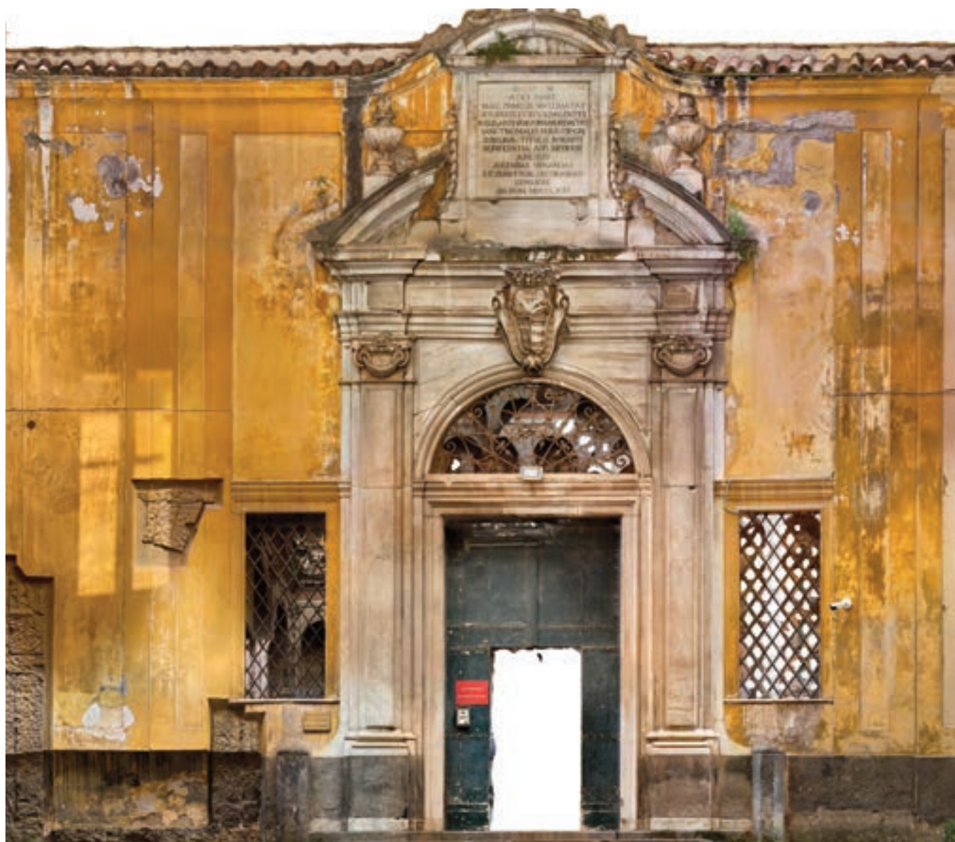
59. Chiesa di s. Maria di Donnaregina. Dettaglio della parte centrale del prospetto est, lato vico Donnaregina, in prossimità dello spigolo con la facciata principale. In primo piano pregressi interventi di sistemazione dello spigolo
