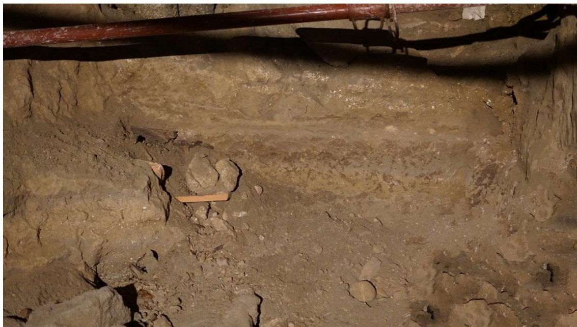
Fig. 15. Dettaglio delle tombe pavimentali distrutte (foto B. Santoro).
