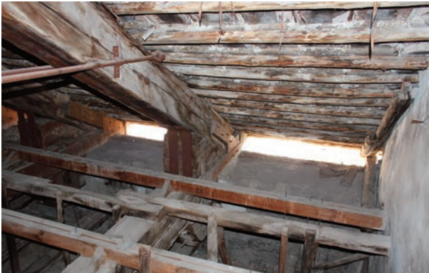
44. Sottotetto della Chiesa di s. Maria di Donnaregina. Fessurazioni longitudinali verificatesi dopo il 1996. Puntone est della capriata n.12
