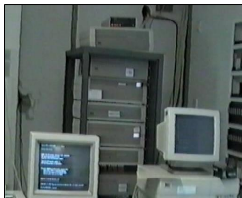
Fig. 9 - I modem di collegamento dello snodo telematico.
